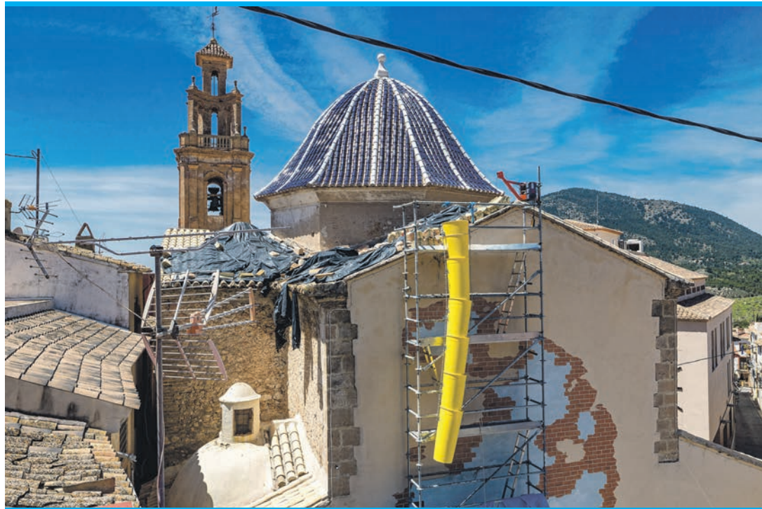
Die Ausbesserung der Schäden am Kirchendach geht nicht voran. Foto: David Revenga
